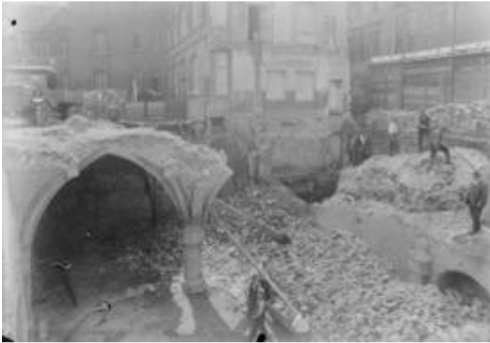
Démolition de l'hôtel de la Bulette et de ses caves voûtées gothiques en 1934. © Coll. B.M. Metz.
