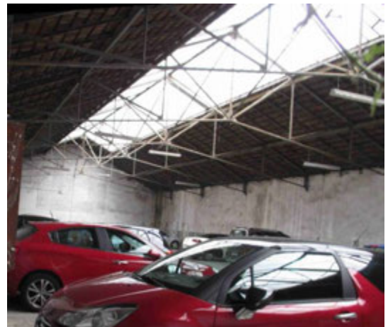
Ancien bâtiment artisanal ou de petite industrie en fond de parcelle, 6 rue Pierre-Perrot (extérieur et intérieur).
