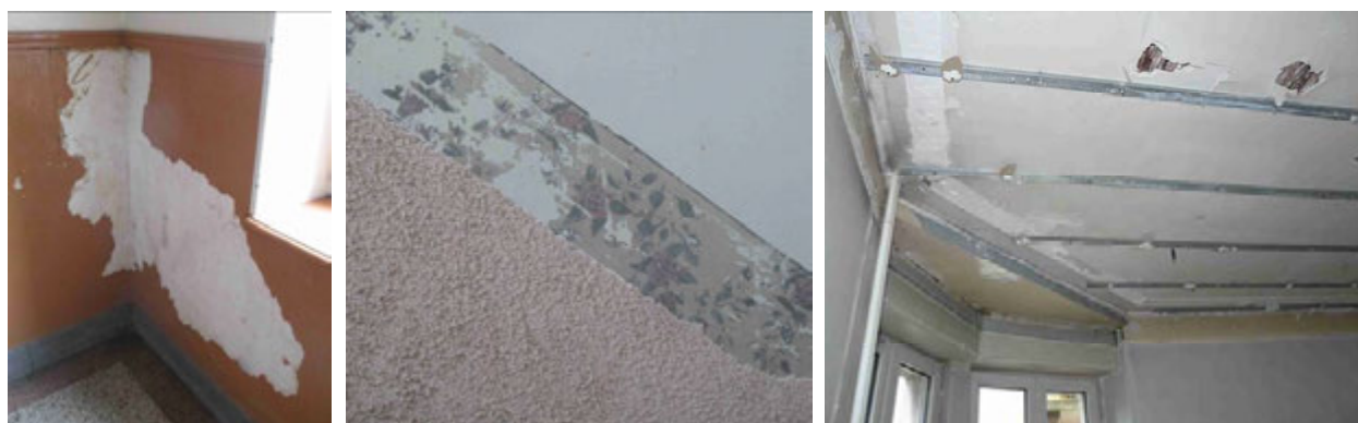
Pose d'enduits, crépis ou revêtements inadaptés à la respiration du bâti, induisant des désordres (à gauche), masquant également des décors (au pochoir, au centre), et rabotage des décors moulurés pour poser des doublages sous les plafonds (à droite).
